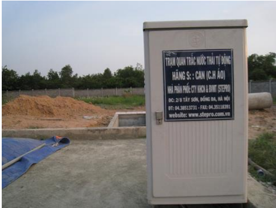
Trạm quan trắc tự động lắp đặt tại KCN Hồ Nai
