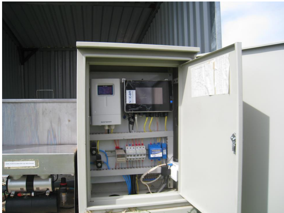
Trạm quan trắc tự động lắp tại nhà máy Bia SG Phú Thọ
