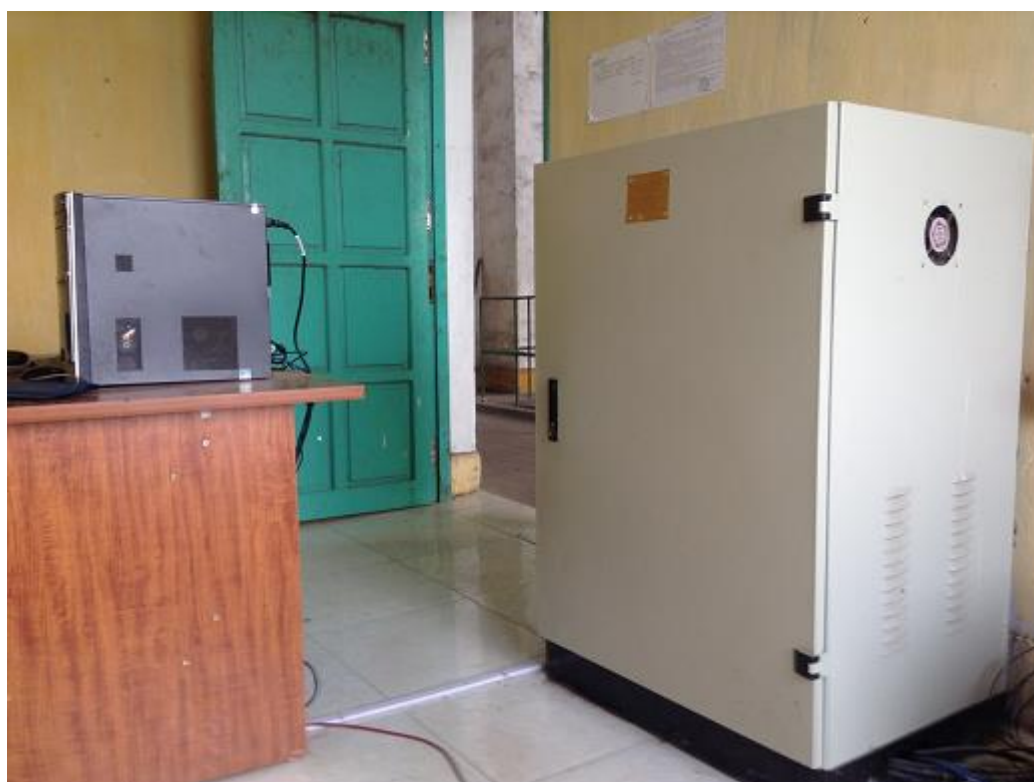
Trạm quan trắc nước lắp đặt tại Cty Đạm Hà Bắc
